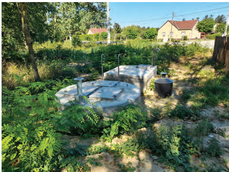
2. kép: Püspökbólyi végátemelő és szerelvényakna
