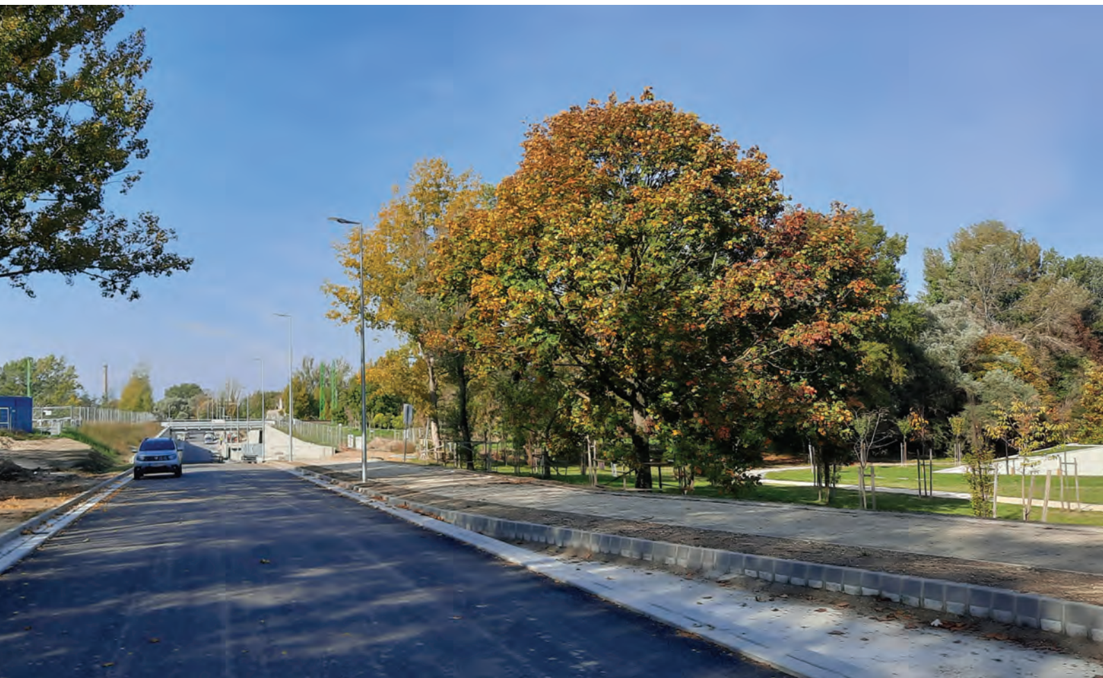
5. kép: Útépítés 0+650 szelvény AC-22 kötőréteg sárberki oldal (fotó: Varga Zoltán, A-Híd Zrt.)
