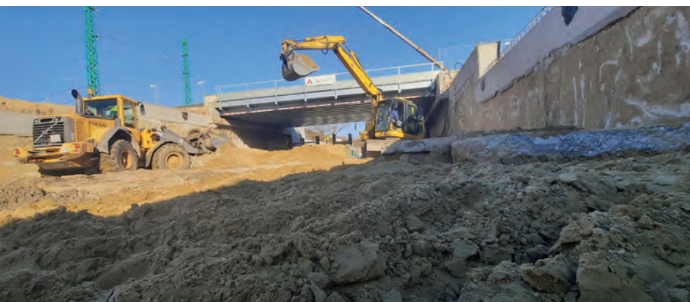
4. kép: Aluljáró „C-D” dilatáció bevágás fejtés bánhidai oldal (fotó: Varga Zoltán, A-Híd Zrt.)
