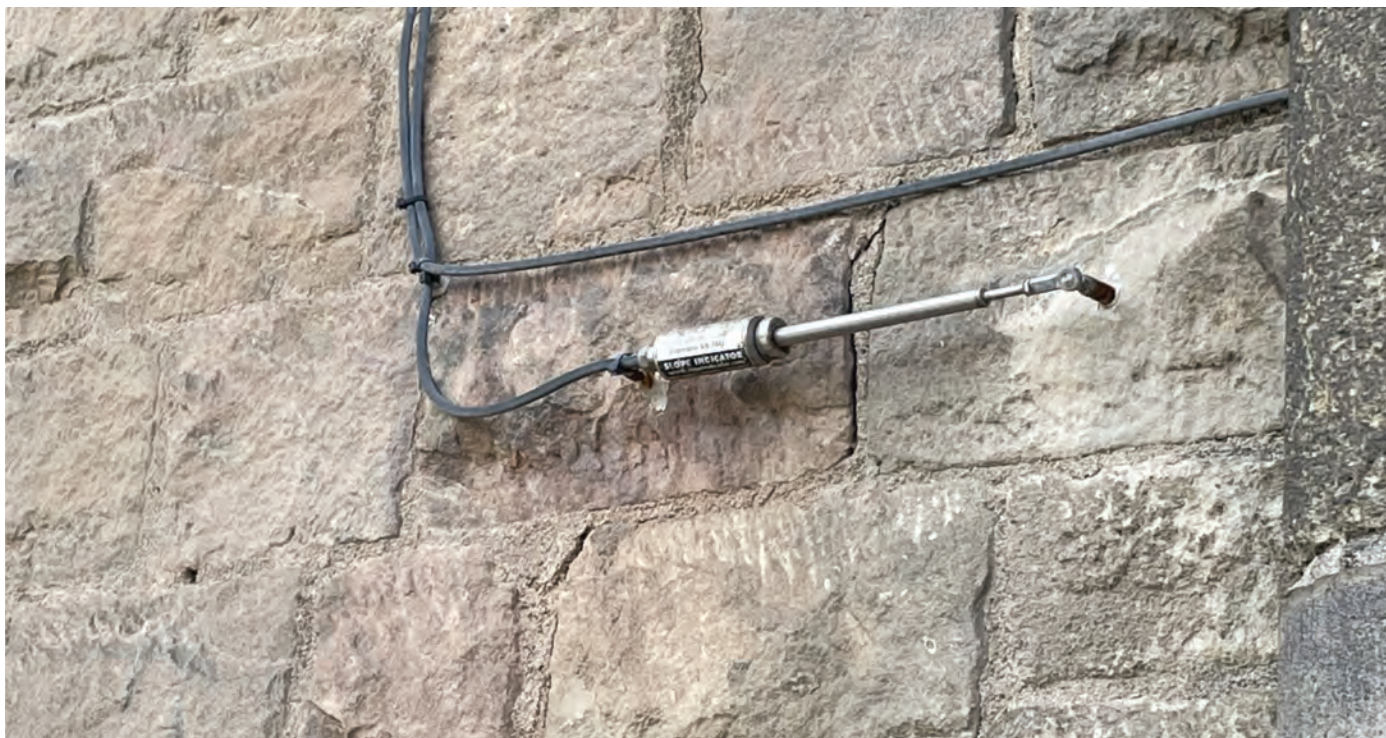
1. ábra: Műszeres repedésmonitoring falazott építményen
