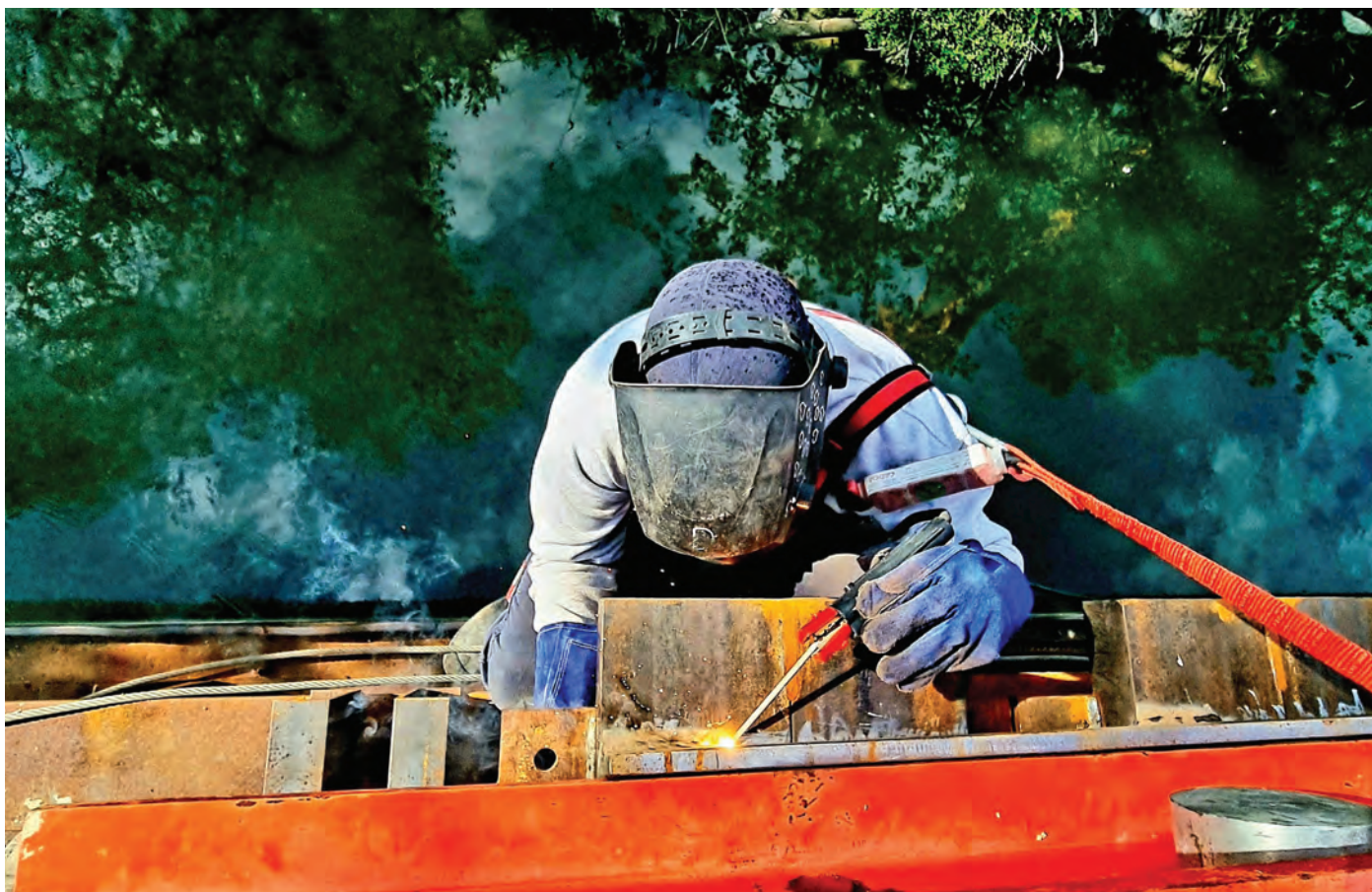
Tímár István Projekt fotók I. helyezett Kalocsa-Paks Új Duna-híd Zsalukocsi szerelése (hegesztési munkálatok)
