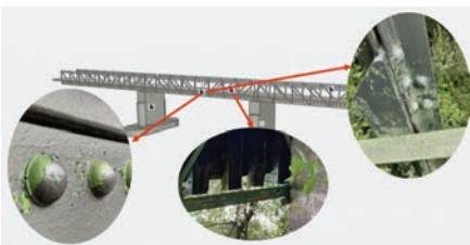
Állapotfelmérés a Trimble Connect segítségével: a modellhez csatolt fotók
